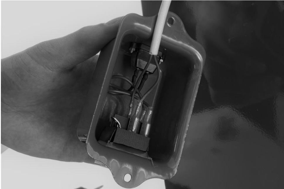
Figure 15 : Raccordement du câble à l'interrupteur
