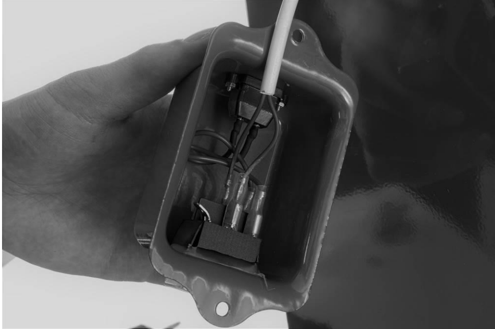
Figura 15: Collegamento del cavo allo switch
